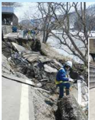
4/1 国道403号土砂崩れにより道路欠壊
